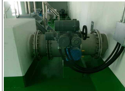
<유입밸브실 배관 양호>
