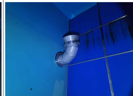
<2지 유입배관 양호>
