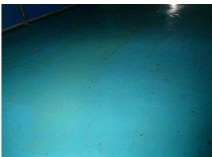
<1지 바닥슬래브 균열>
